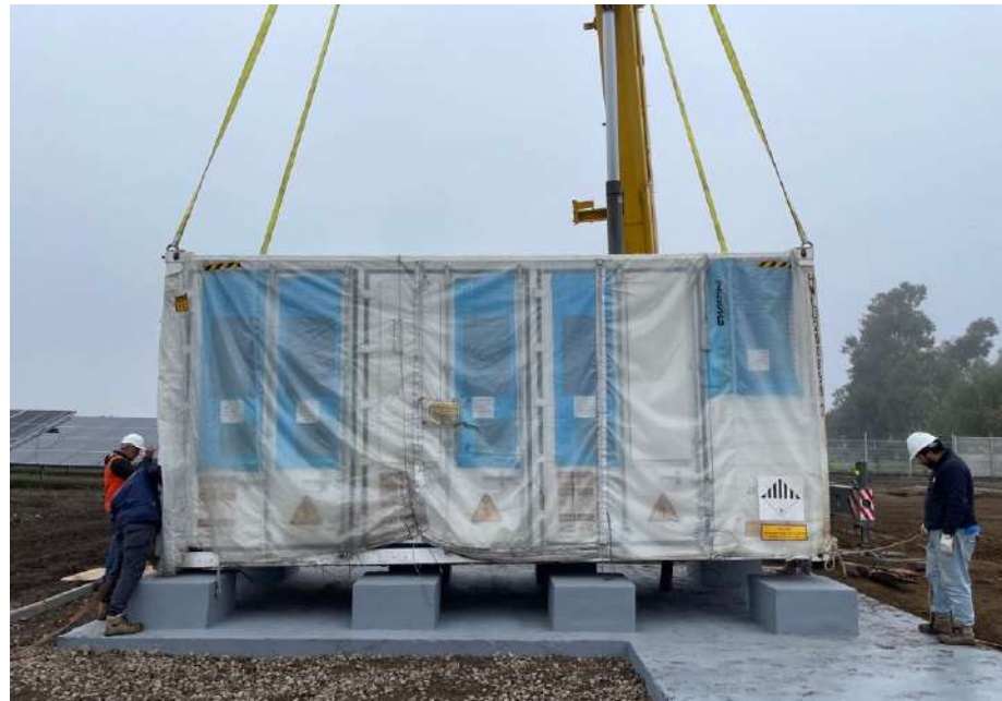
Fotografía: First Huawei Smart String ESS in Chile & LATAM, OEnergy
